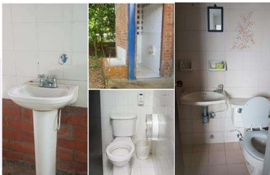
Imagen 6. Inventario de grifos y baterías sanitarias sede Sur, Estación 1 y 2.
